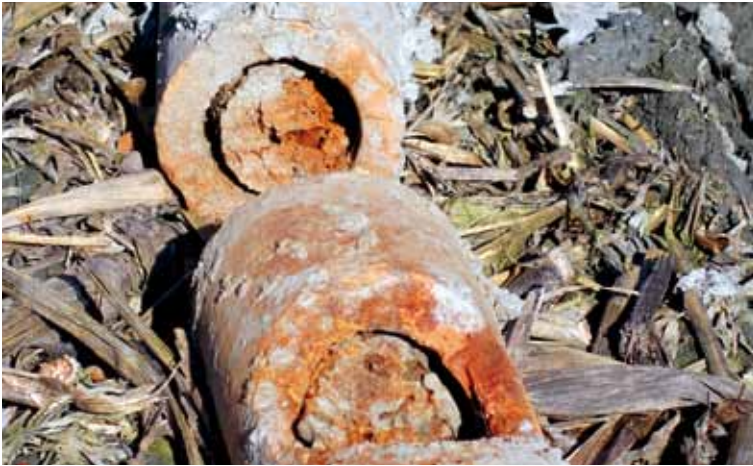
Tonrohrsystem Scheidgraben bis Landstrasse: Ist in einem sehr gutem Zustand (Baujahr 1964). Sehr starke Verschmutzung durch Ockerbildung.
