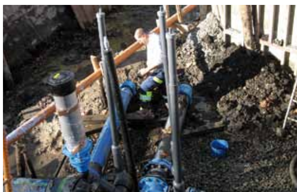
Wasserschiebereinbauten als Abzweiger in den Grossen Britschen.
