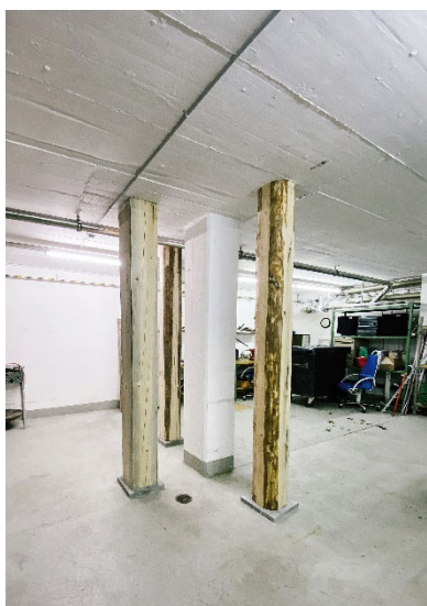
Abbildung 2: Um ein Durchstanzen des Saalbodens zu verhindern, wurden die vier Stützen mit Baumstämmen verstärkt.
