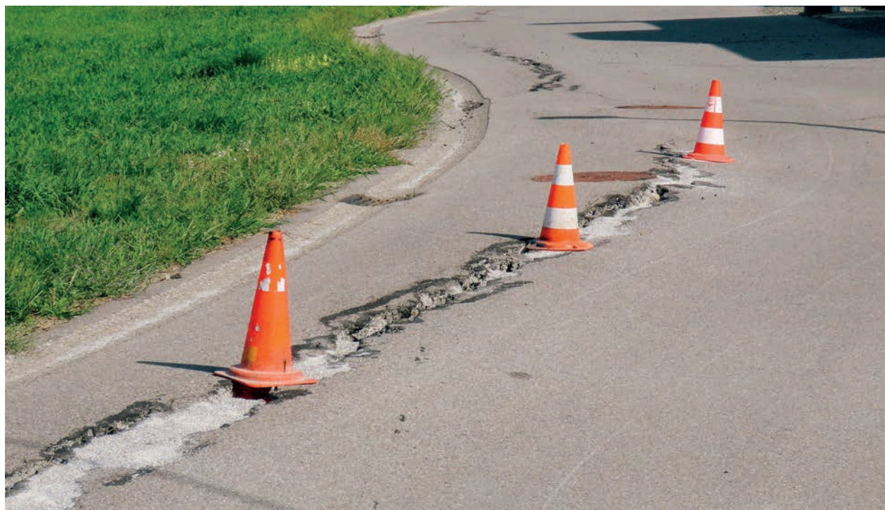
Fahrbahnschäden durch Untergrundsetzungen
